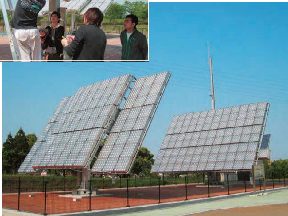
学内に設置した2基の14キロワット集光型太陽光発電システム
