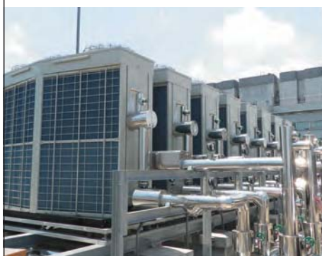
省エネ化のために更新した大型熱源機器の一つ
