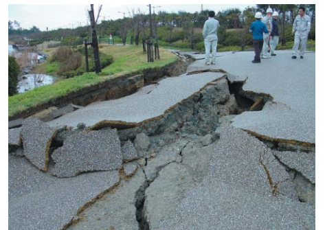
液状化によりガタガタになった歩道（福岡市内の公園）
