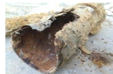
配管の腐食（給排水管）
