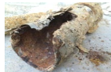
配管の腐食（給排水管）
