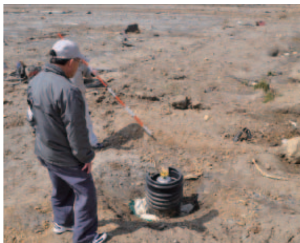
津波による灌漑用水パイプライン田区取水施設被災状況（陸前高田市）
