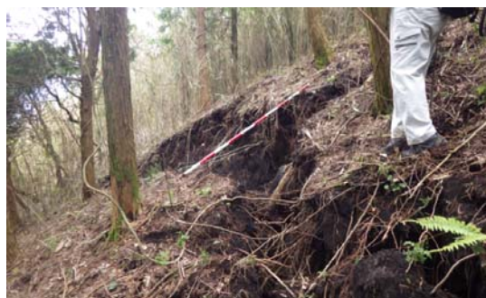
阿曾大橋付近の大規模な斜面崩壊の周辺の斜面上の亀裂（H28.4.23撮影）
