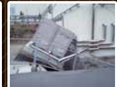
陥没により傾く ニュートリノ施設空調機室外機
