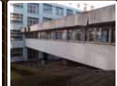
講義棟をつなく 渡り廊下の破損
