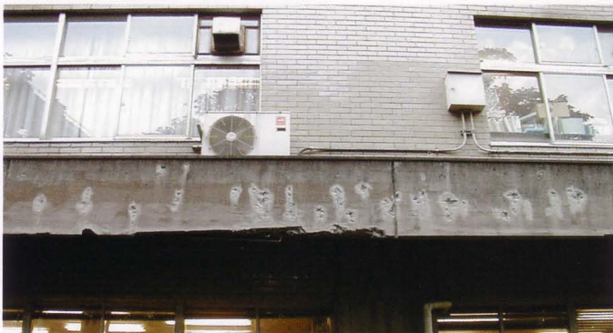
▲ 老朽建物は外壁の剥離や雨漏り等の問題が多発。
