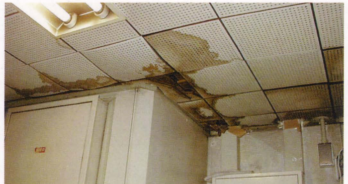
▲ 雨漏りで天井や壁がよごれ劣悪な環境の実験室。
