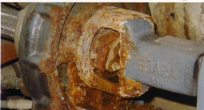
▲ 配管、ポンプ、電気設備等の老朽化も深刻。
