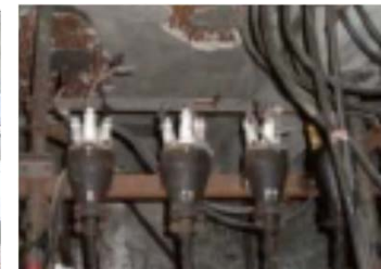
電気ケーブルの劣化
