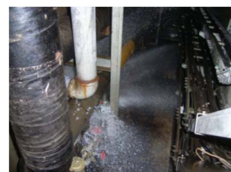
配管の破損による水漏れ
