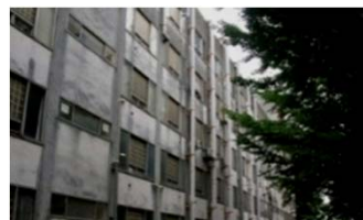
外壁・サッシの落下の危険
