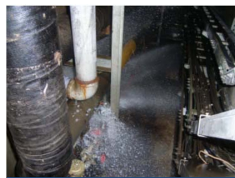
配管の破損による水漏れ
