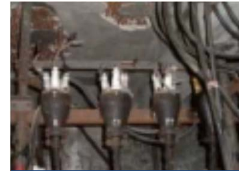
電気ケーブルの劣化
