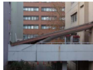
連絡通路の屋根崩落
