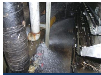
配管の破損による水漏れ
