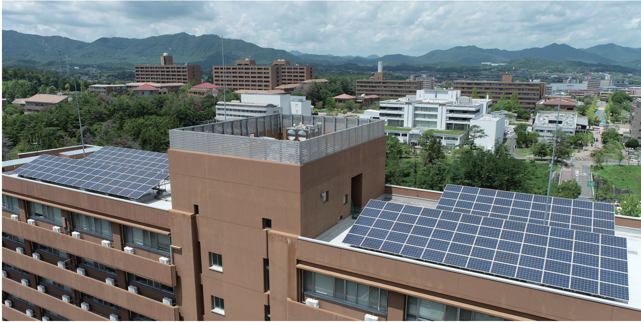
大学校舎屋上に設置された太陽光パネル（広島大学提供）
