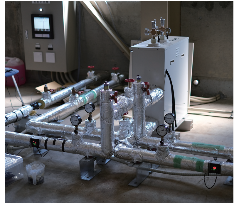
地中熱利用の実験設備（広島大学提供）
