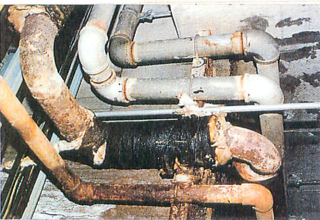
写真5：共同構内暖房管
