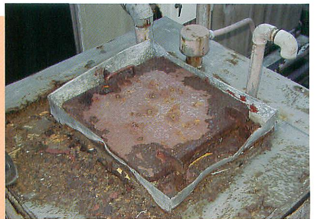
■写真6：膨張タンク(水槽)
